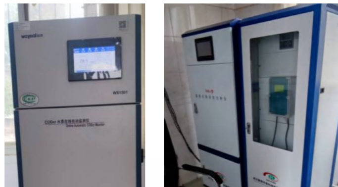
污水处理站在线监测设备
