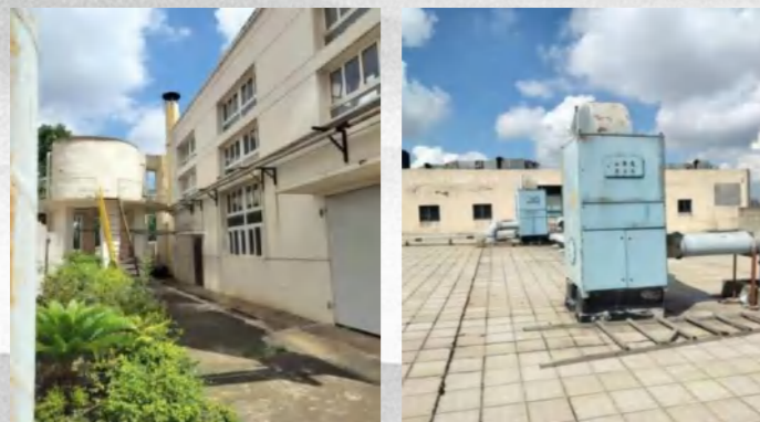
废气处理装置
