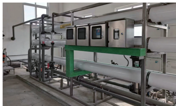
废水处理中水回用设施
