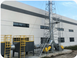
废气采样平台
