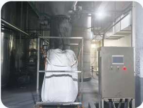
废硅藻土提铜回收装置
