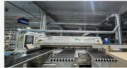
车间除尘设施
