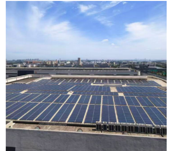
光伏发电设施
