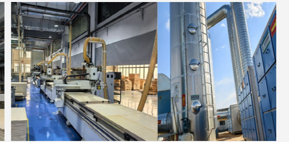
生产基地安全隐患排查
