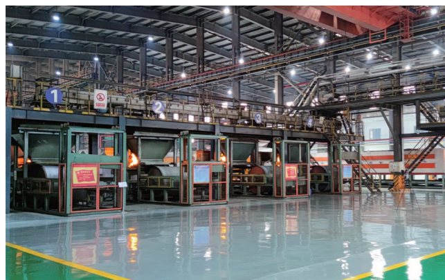
鲁银新材生产车间设备
