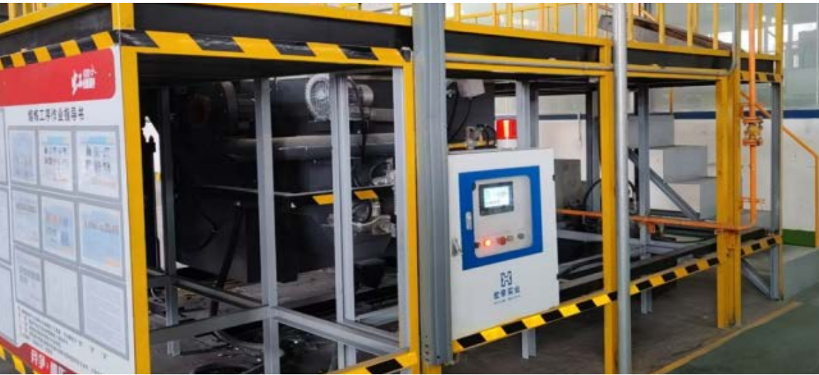
双蓄热式节能倾倒炉投入
