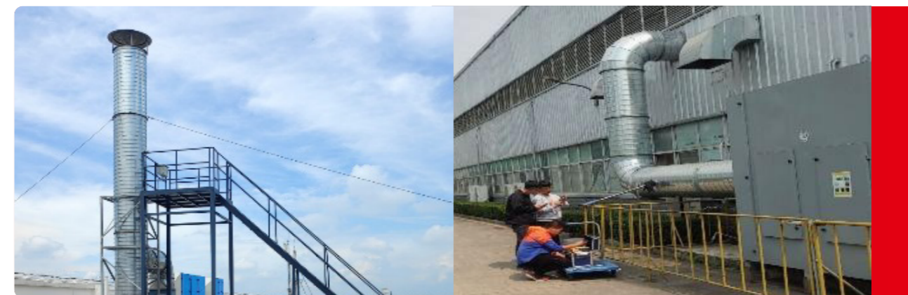
● 废气治理设施
