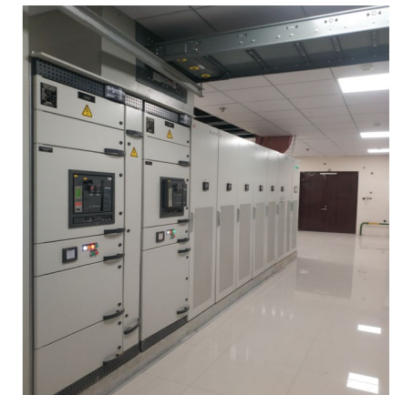
10kV直转380V直流电源系统
