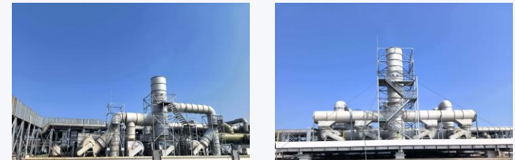
部分废气处理设施
