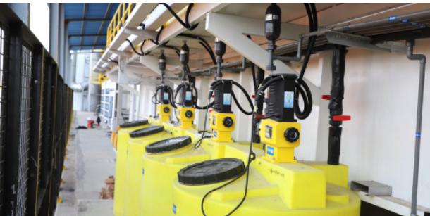
厂区污水处理站设施
