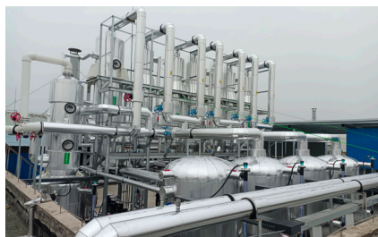
氨气回收设备
