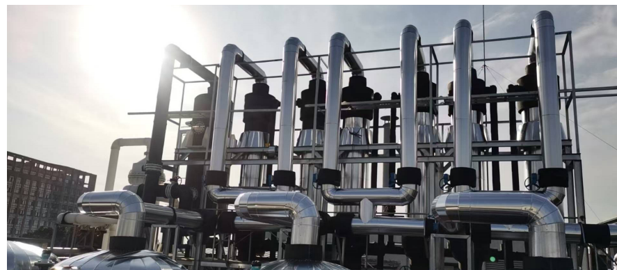
安徽三安氨水回收装置改造
