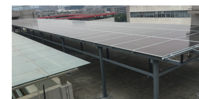
远光软件珠海总部园区光伏电站
