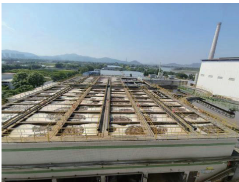
廠區內污水處理設施
