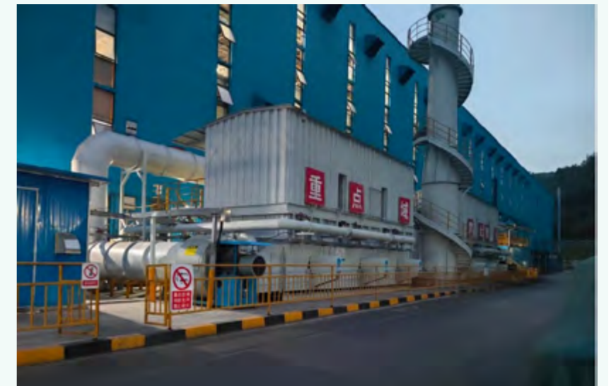
四川贝特瑞 RTO 废气处置设施
