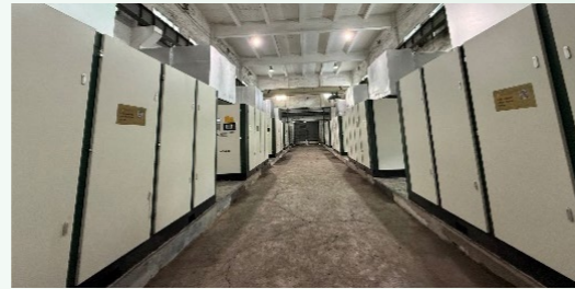
改造后空压站
