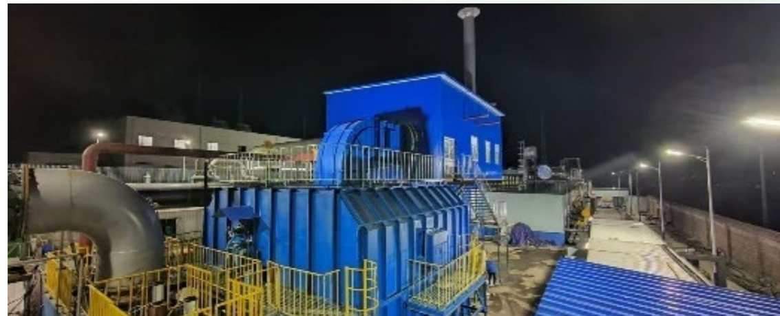
五阳矿南岭风井瓦斯氧化供热设施
