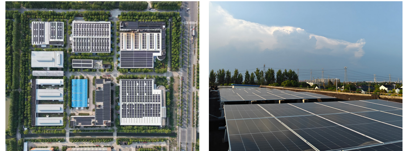
奉贤生产基地光伏发电
