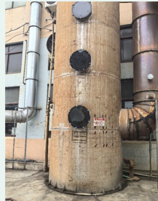
热洁炉废气 排放口标识整改前
