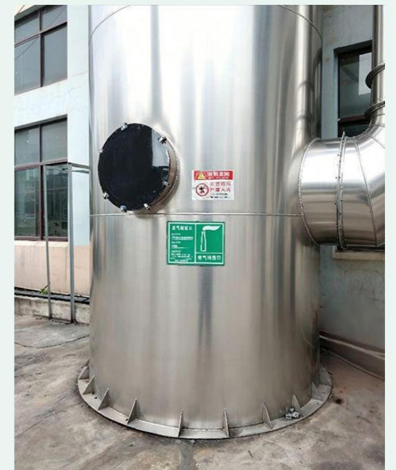
热洁炉废气 排放口标识整改后
