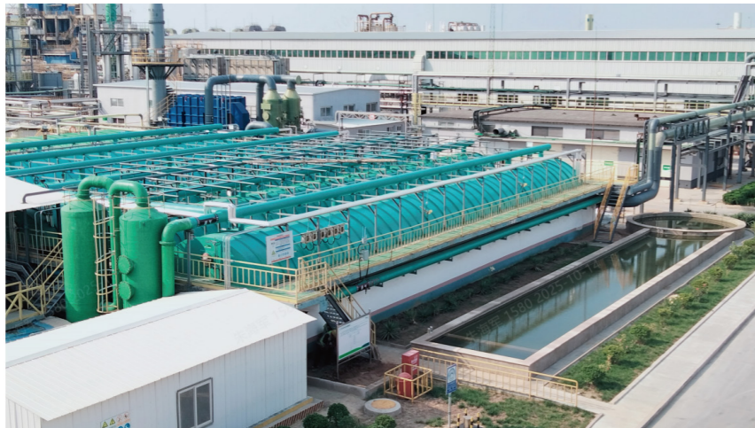
废水处理设施
