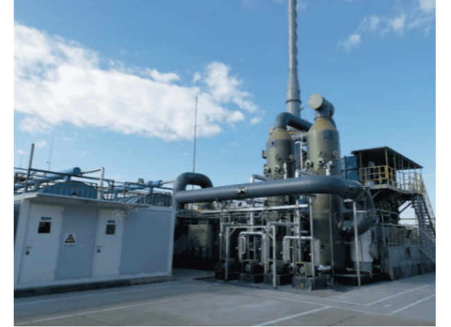
废气处理设施
