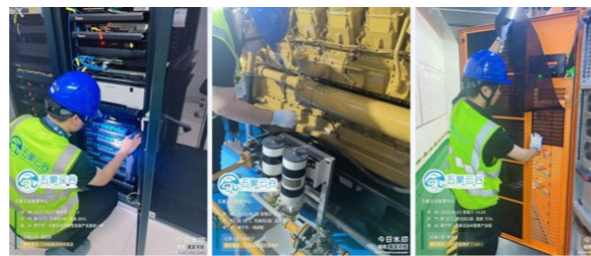
五象云谷智算中心运维作业
