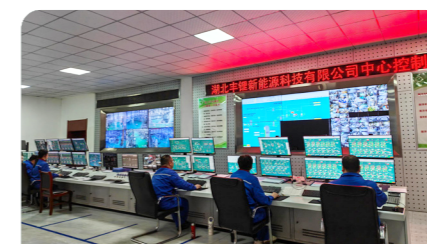
丰锂新能源中心控制室
