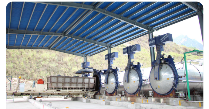
湖北荆门总部 α 石膏粉生产车间
