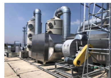
净化处理装置
