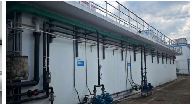
废水设施连接处
