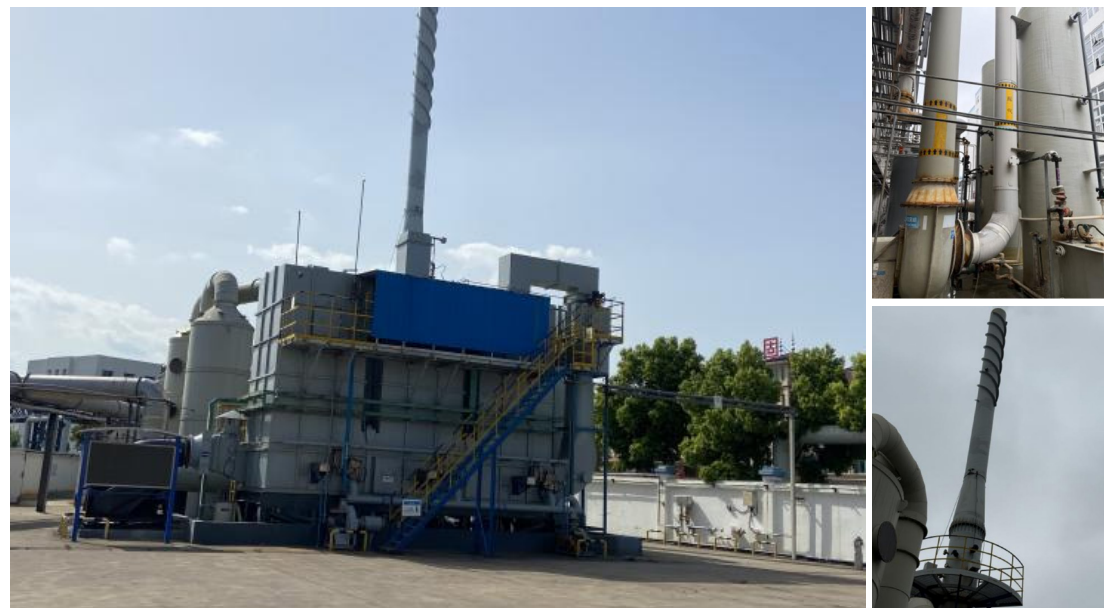
废气处理设施及排气筒
