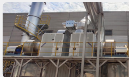
VOCs氧化余热回收装置
