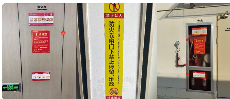
本集團的辦公室亦已配備防火消防設備，以防發生火災
