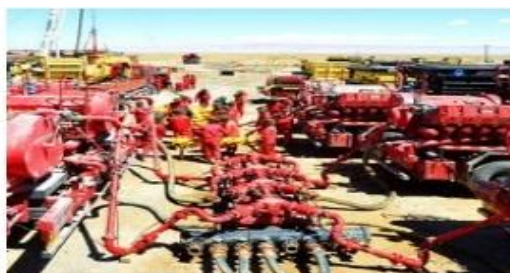
油田压裂系统装置
