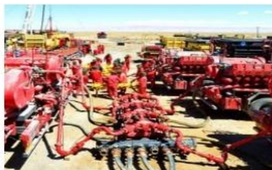
油田压裂系统装置
