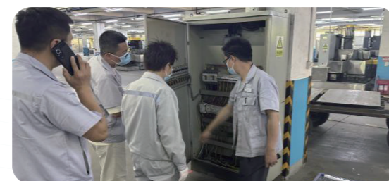
现场安全隐患排查
