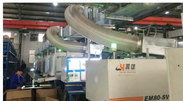
烘干、注塑废气收集系统现场
