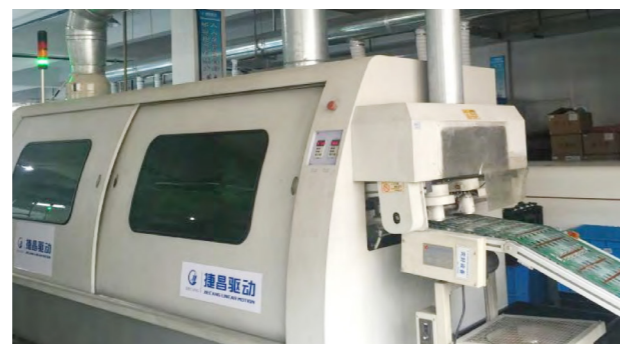
焊接、点胶、烘干废气收集系统现场
