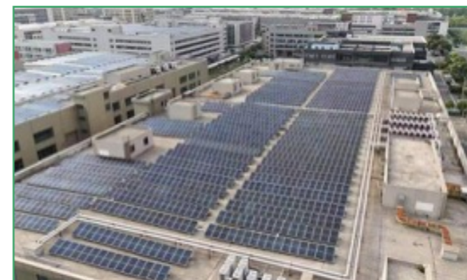
▲ 苏州精濂厂区屋顶 1MW 分布式光伏发电系统
