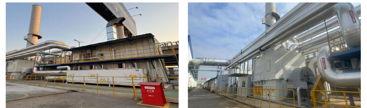
涂装车间 RTO 设备设施
