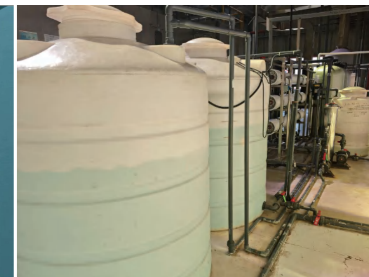
冷凝水回收设备
