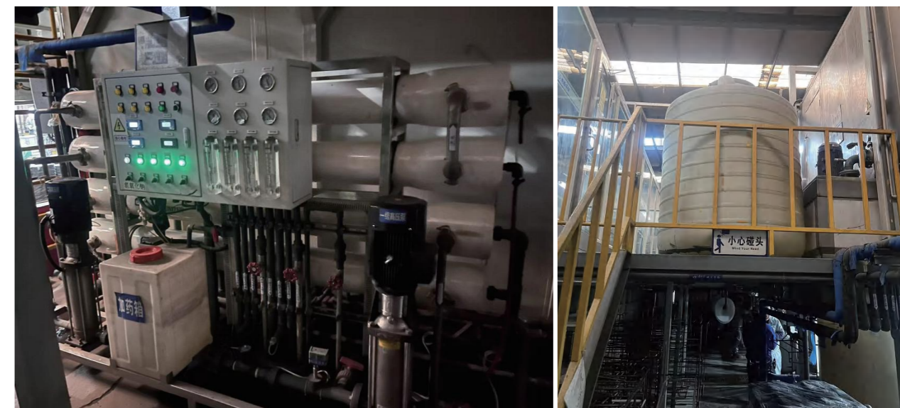
华翔科技长春工厂废水回收二次利用设备
