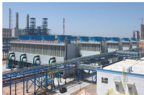
神华宁煤消雾节水冷却塔项目
