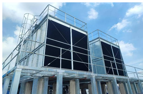
泰国 True IDC 数据中心项目
