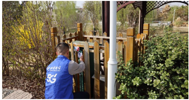
工作人員對通信設施進行巡檢維護
