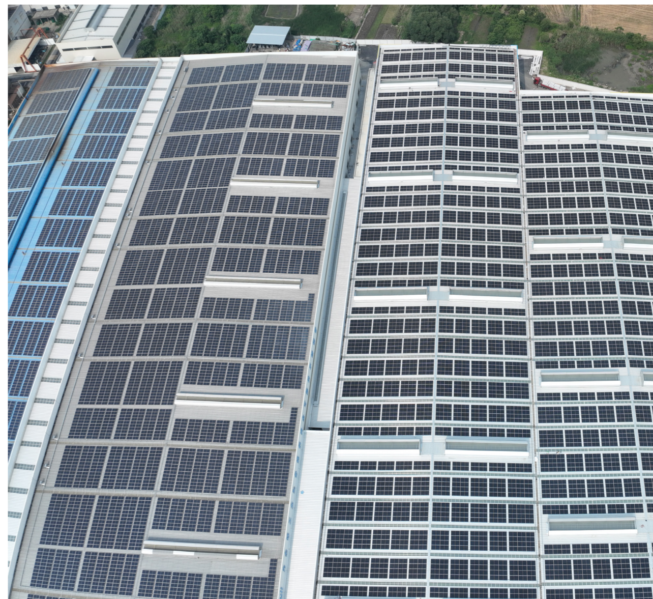
冶金复合管光伏项目
