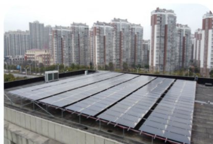
开润滁州总厂屋顶分布式光伏
