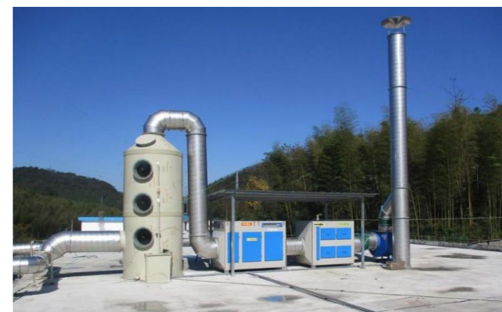
公司废气处理设施
