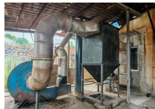
改造前生物质锅炉
