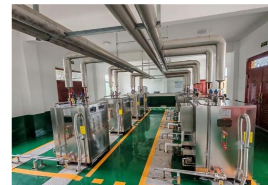
改造后电蒸汽发生器
