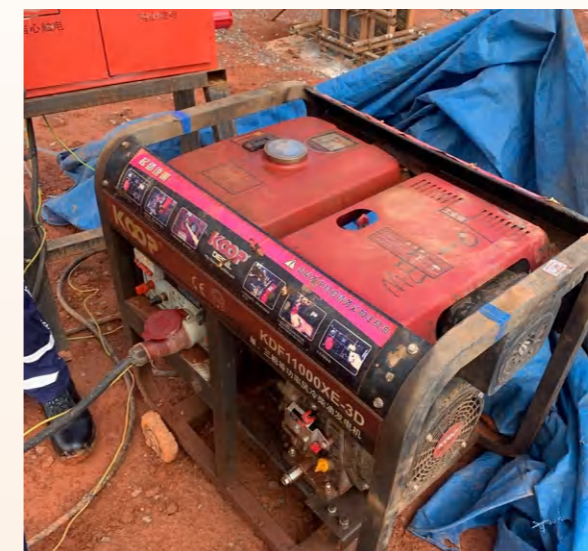
设备漏油情况检查
