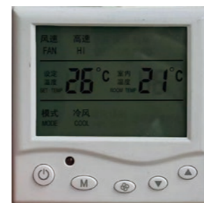
厂区空调变频控制
