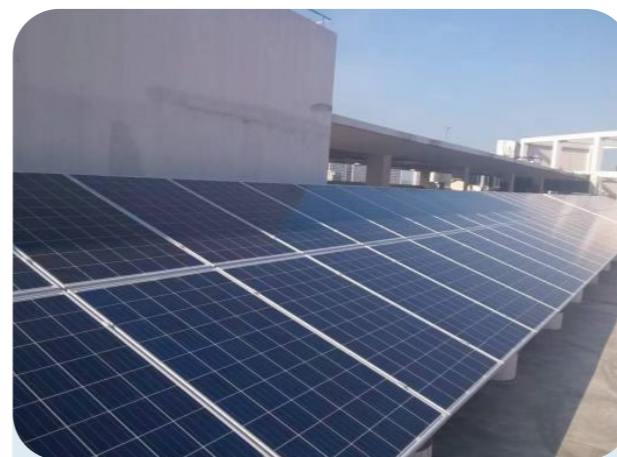
公司办公楼顶层铺设的太阳能光伏板
