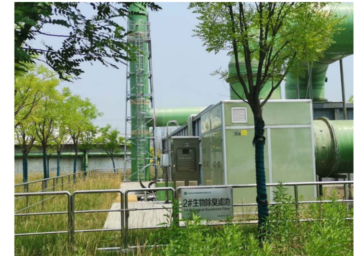
咸陽路污水處理廠除臭系統
