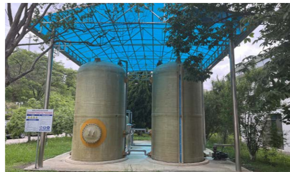
貴州創業水務有限公司中水處理裝置
