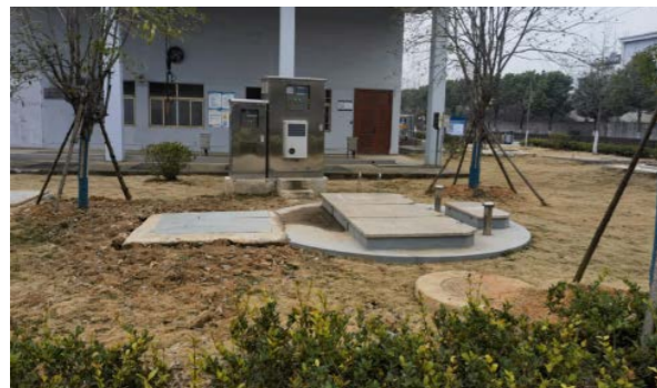
鹹寧創業水務有限公司中水泵站
