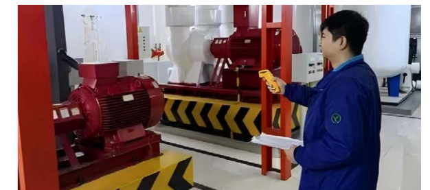
綠能公司供熱設施檢查
