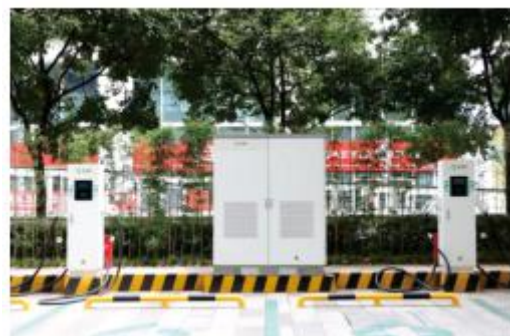
图 2-7 储能项目- 菁蓉汇超充站
