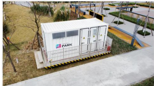
图2-5 智能微电网项目-IC设计产业园
