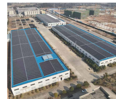
◎汇久管业3.41MWp光伏项目
