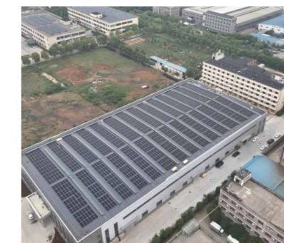
◎铜陵科宇电子820kW光伏项目
