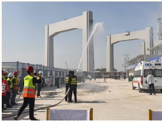
▲ 项目消火栓实操演练
