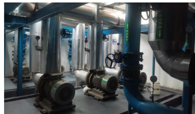
冷冻泵、冷却泵
