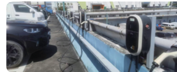
新能源充电桩
