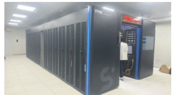
岚山厂区模块化智能机房
