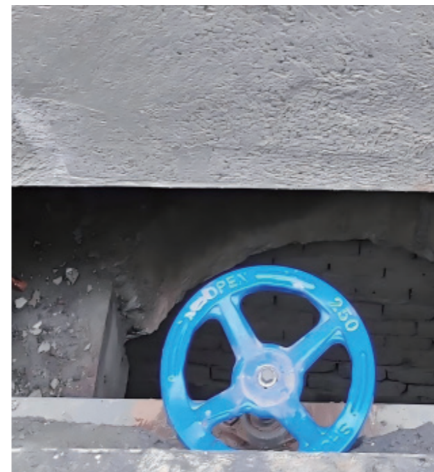
厂区雨水收集管网
