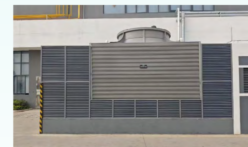
循环水冷却塔
