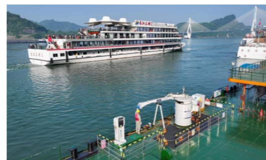
电动船高压充电桩
